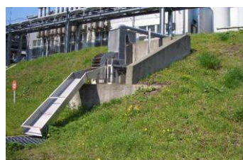
水力発電機(2015年3月)
