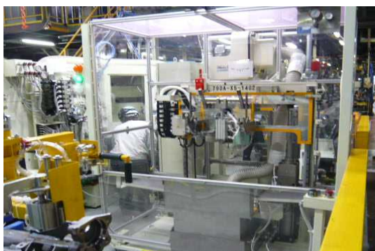
新設したJPN TAXI足回り部品の切削、研磨、洗浄設備
