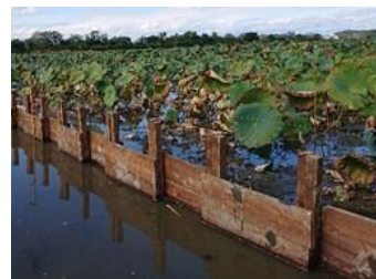
沼内に設置された様子
